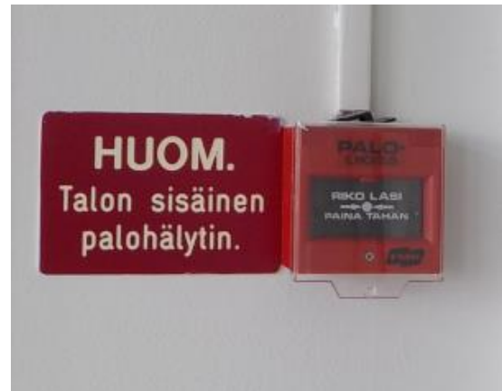
Paloilmoittimen painike käytävällä
