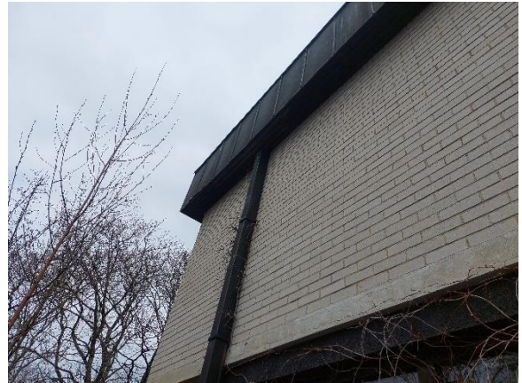
Betonipalkissa halkeamia/rapaamaa. Köynnös syöksytorven ympärillä.
