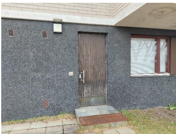
Puu-ulko-oven puuosat vaurioituneet.
