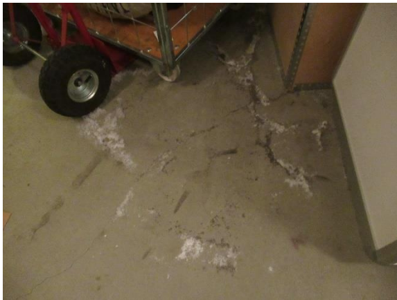
Kosteusjälkiä väestönsuojan lattiassa
