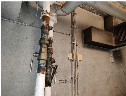
Lämmitysverkoston alkuperäiset sulkuventtiilit ja linjasäätöventtiilit.
