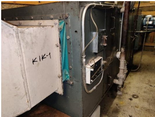
KIK-1 ilmanvaihtokone, (TK3)
