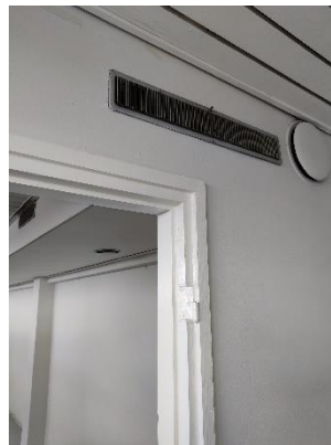
Työhuoneen ilmanvaihdon päätelaitteet.
