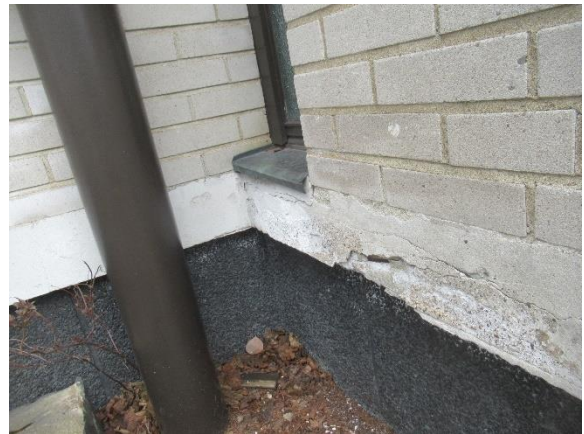
Ikkunapellin kallistus vaatimaton, seinässä tummentumaa ja betonivaurioita
