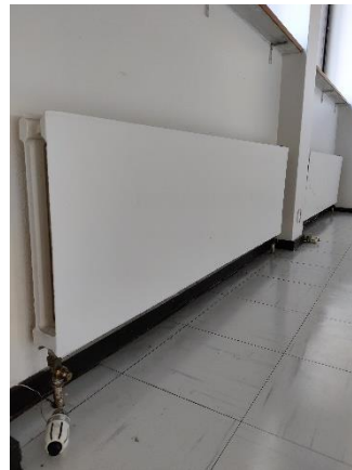
Lämmityspattereita, termostaattit irrotettu.
