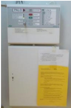
Paloilmoitinkeskus teknisessä tilassa
