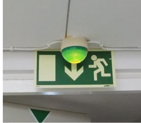
Poistumistievalaisin sekä jälkivalaisevakyltti toimistossa
