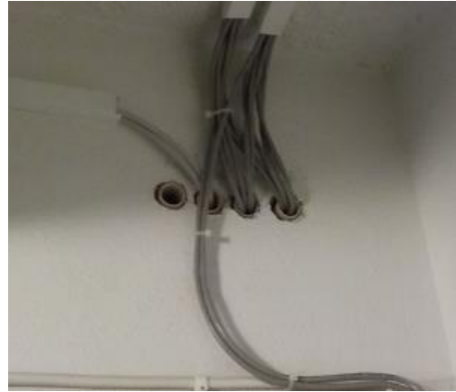
Läpivientejä putkitettuna varastossa
