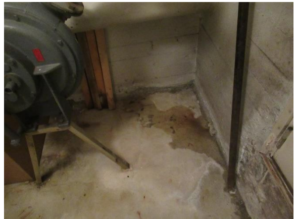
Vettä väestönsuojan lattialla (vieressä VSS-hä- täpoistumistie)
