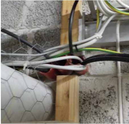
Rakennuksen sisälle tulevia putkia teknisessä tilassa
