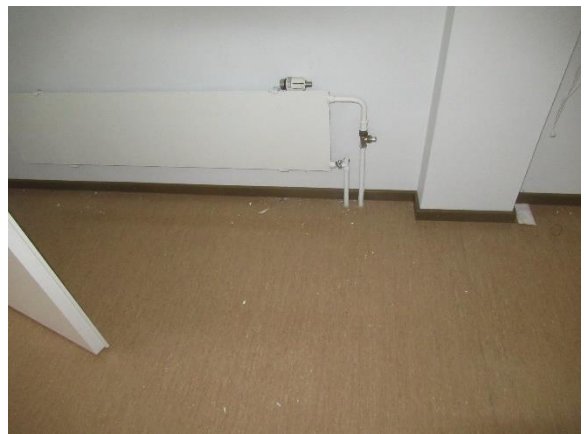
Pattereiden kohdilla kosteutta noussut jalkalis- tojen taustalle/yläpuolelle ja irrottanut tasoit- teita
