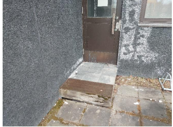
Pohjakerroksen sisäänkäynnin ympärillä kosteusjälkiä
