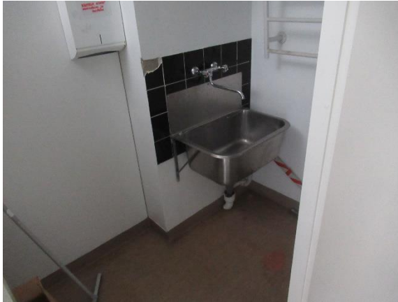
Lavuaarin taustalaatoituksen laatta rikki
