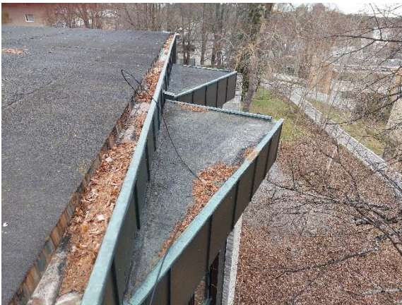
Yleiskuva erkkerin vesikatosta, sadevesikourussa runsaasti roskaa
