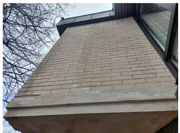
Erkkerin betonirakenteita paikkakorjattu aikojen saatossa. Betoniosissa halkeamia ja rapaamaa
