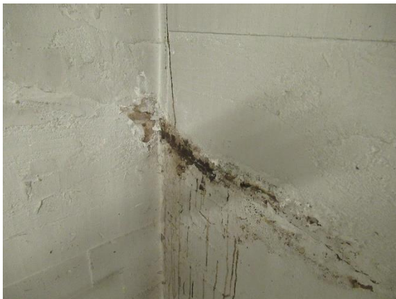
Väestönsuojan seinässä kosteusjälkiä
