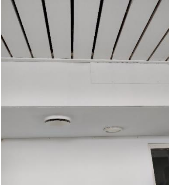
Uusitut ilmanvaihdon päätelaitteet.
