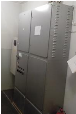
Pääkeskus teknisessä tilassa
