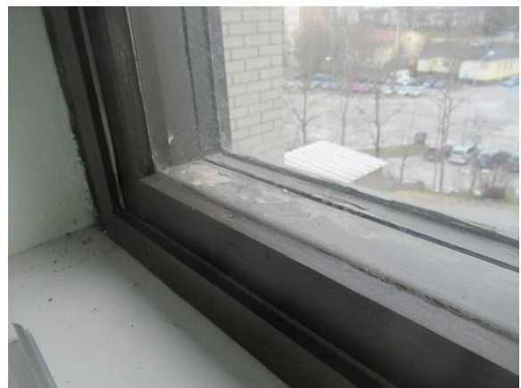
Puuikkunoiden puitteiden välissä kosteusjälkiä ja pinnoitevaurioita
