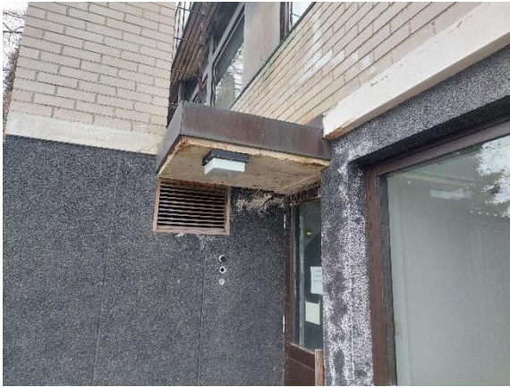
Pohjakerroksen sisäänkäynnin ympärillä kosteusjälkiä
