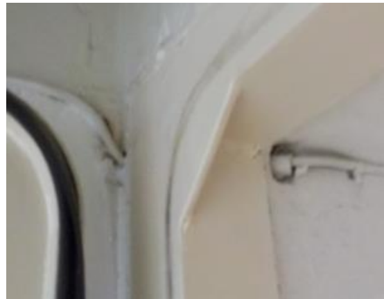
Väestönsuojan oven kiertävä läpivienti
