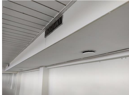
Ilmanvaihtokanavistot koteloinnin sisällä.
