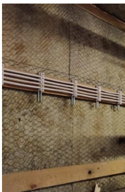
Ilmanvaihtokonehuoneen seinät pinnoittamattomalla villalla.
