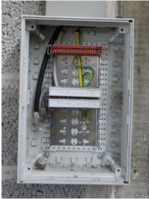
Puhelimen liittymiskaapeli päätettynä koteloon teknisessä tilassa
