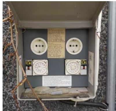
Ajoneuvon lämmityspistorasiakotelo seinällä
