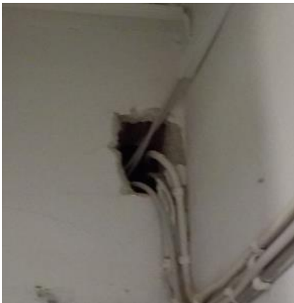
Läpivienti teknisessä tilassa
