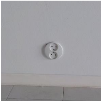
0-luokan pistorasia aulassa
