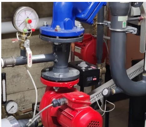
Lämmitysverkoston toimilaitteita ja anturointia
