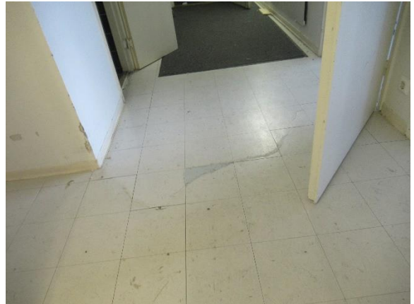
Halkeamia alapohjassa, toisella puolella hie- man painumaa
