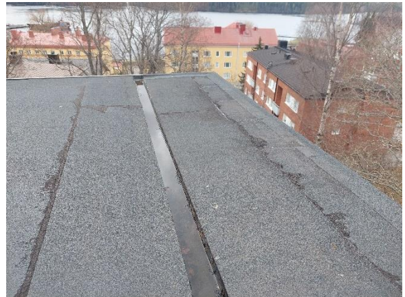
Parvekkeen katon ja varsinaisen vesikaton välissä kouru, jossa runsaasti vettä
