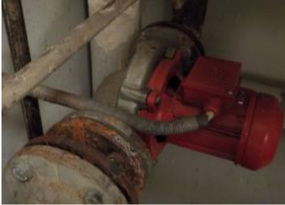
Pumpun sähköistys teknisessä tilassa
