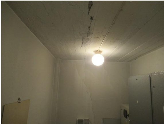
Laaja halkeama seinässä ja katossa kellarikerroksessa
