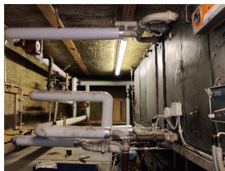
IV-koneiden lämmityspattereiden kytkentäjohdot.
