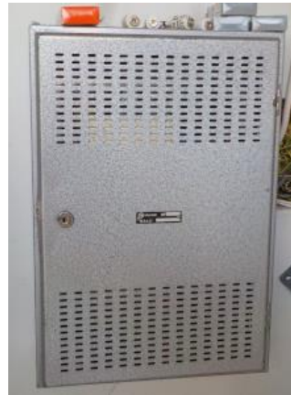
Antennijärjestelmän kaappi keskuskomerossa
