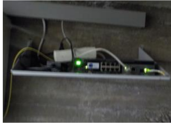
Teleliittymän aktiivilaitteet teknisen tilan hyllyllä
