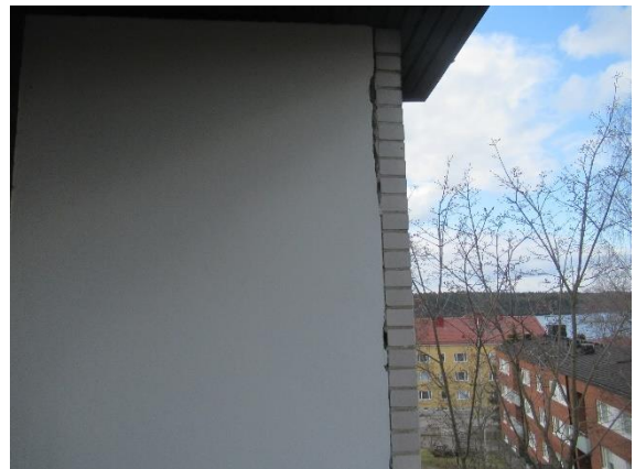
Parvekeseinän ja julkisivumuurausten liitoskohdassa pienimuotoisia vaurioita
