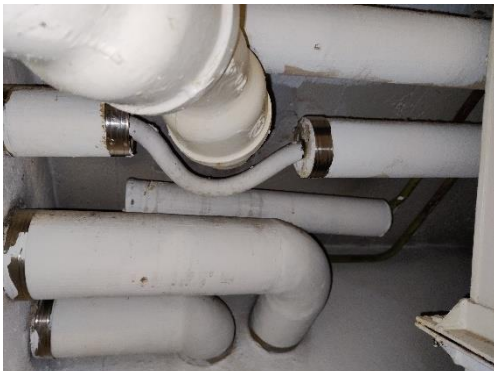
Vesi- ja viemäriputkia.
