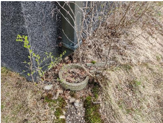
Kattosadevedet johdettuna maahan.
