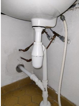
Wc:n kupariset kytkentäjohdot.
