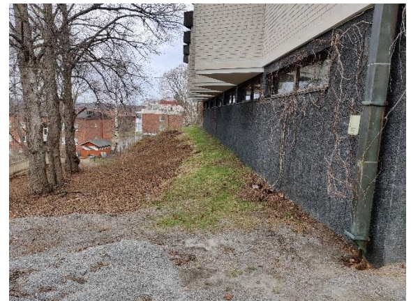
Kattosadevedet johdettuna maahan.
