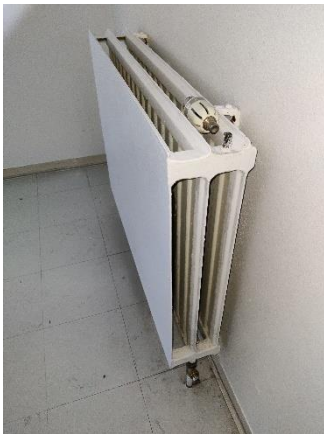
Lämmityspatterit, termostaatti irrotettu.
