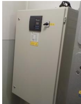
Kompensointilaitteisto teknisessä tilassa
