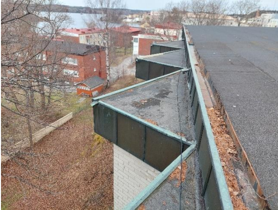
Sadevesikouruissa roskaa, erkereiden kattojen vedenpoisto ulosheittäjien avulla
