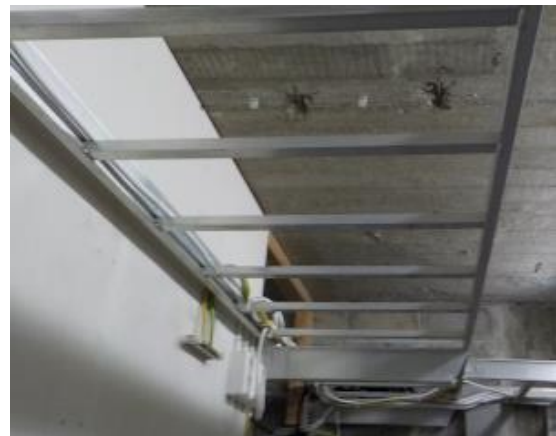
Alumiinista tikashyllyä teknisessä tilassa
