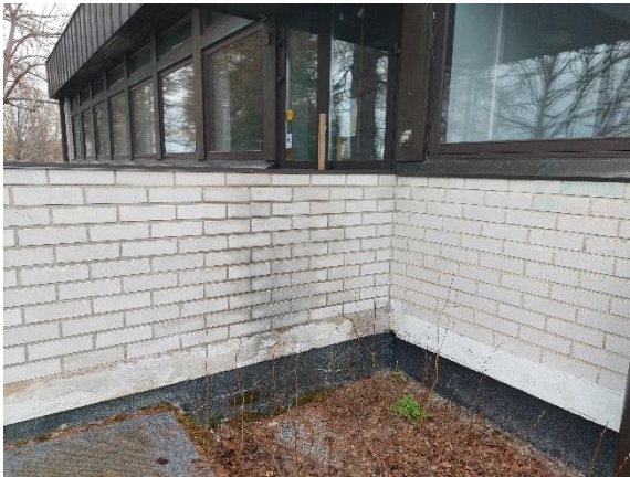
Valumajälkiä julkisivussa, rappaamaa betoniosissa
