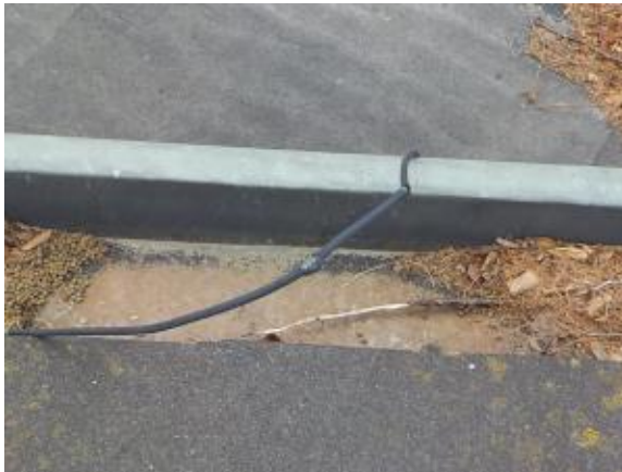
Vaurioitunut sulanapitokaapeli sadevesikourussa
