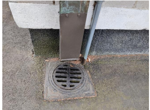
Kattosadevedet johdettuna rännikaivoon.
