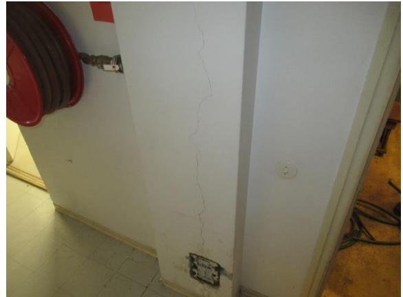
Kellarikerroksen rakenteissa halkeamia
